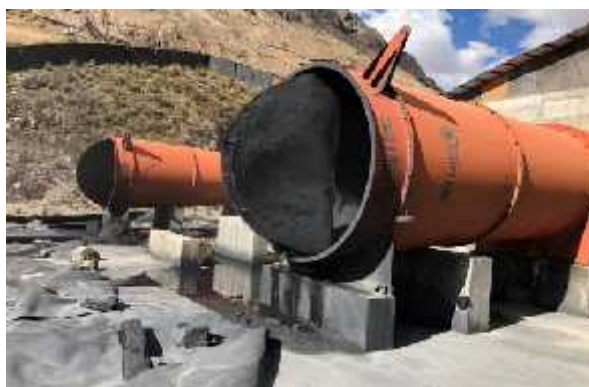
Figura 27. Ventilador principal COD 109. 110 RB 131 de CMCSA.
