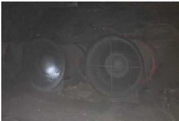
Figura 17. Ventiladores secundarios de 60 000 cfm instalados en paralelo en XC 543 SE.
