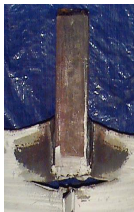
Figura 2.6: Falla en la sección de whitmore de conexión soldada
