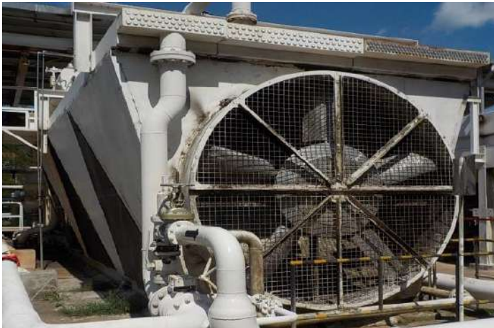
Figura 2.6: Sistema de enfriamiento de Gas y Agua. Fuente: Área de Mantenimiento Aguaytia-Energy.
